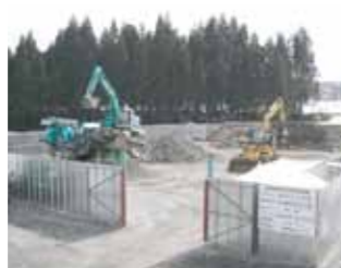
リサイクルプラント(新宮工場)
