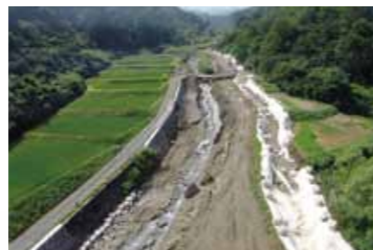
災害現場写真
