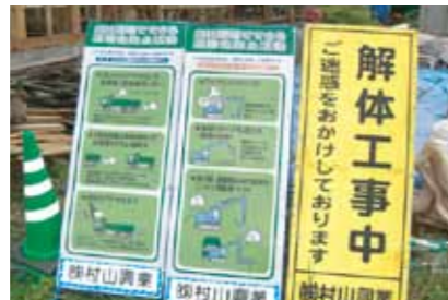
温暖化防止看板設置
